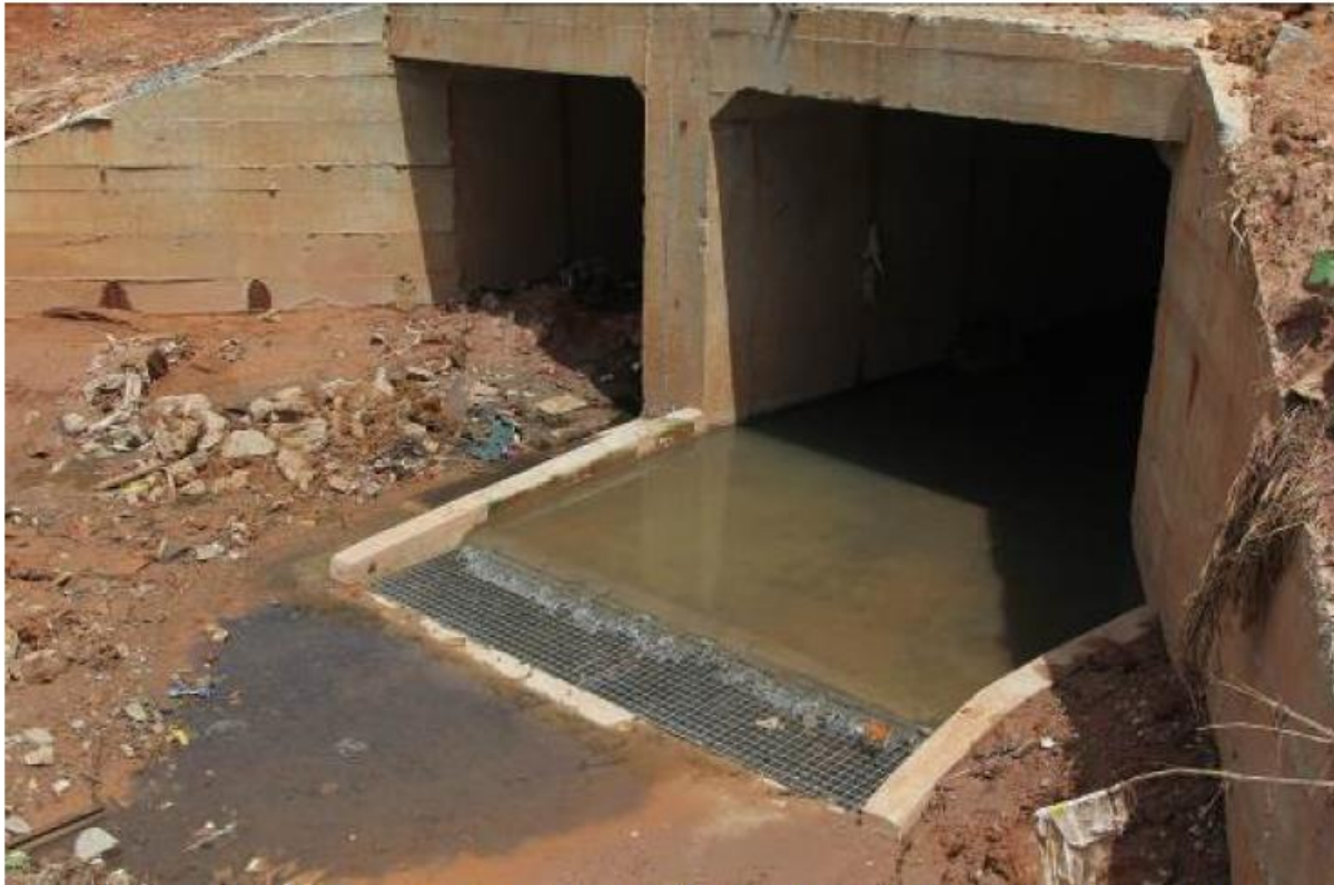
Captação em tempo seco no córrego Águas da Pedreira – Metrô Itaquera
