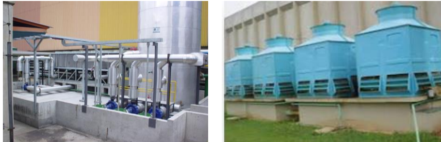
Compressores de água gelada e torres de resfriamento, respectivamente
