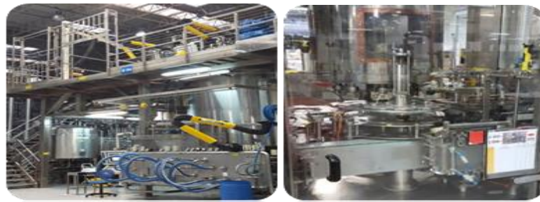
Fotos dos reatores e linhas de envase de produtos onde foi utilizado o B2B
