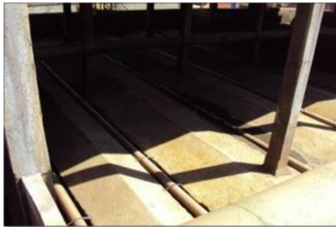
Foto 3. Sistema de purga de lodo em torres de resfriamento
