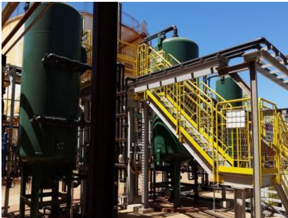
Foto 4. Unidade de desmineralização de água
