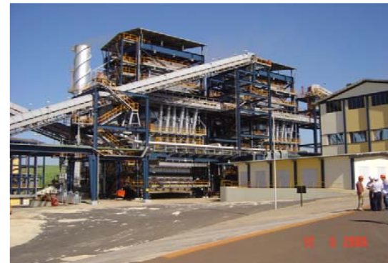
caldeira a vapor
